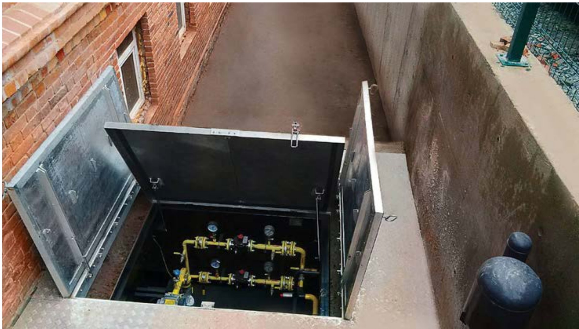
ШРП ПР на объекте культурного наследия «Жигулёвские пивные склады» 1890 года постройки, г. Волгоград
